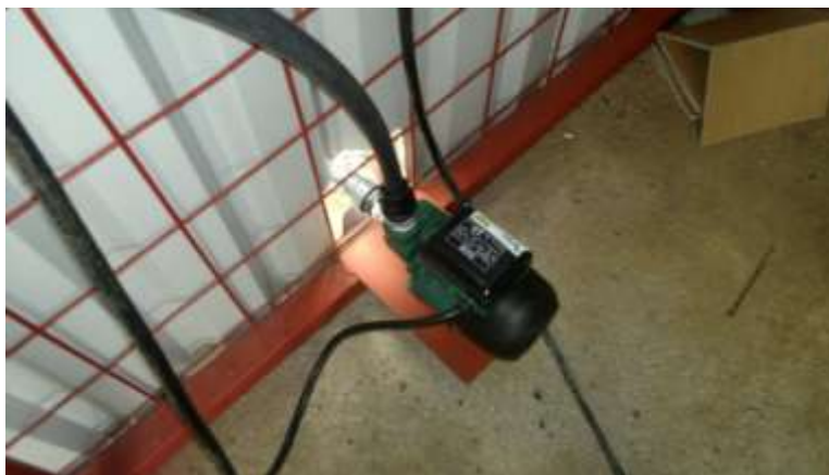
Figura 4.15. Bomba de agua.
