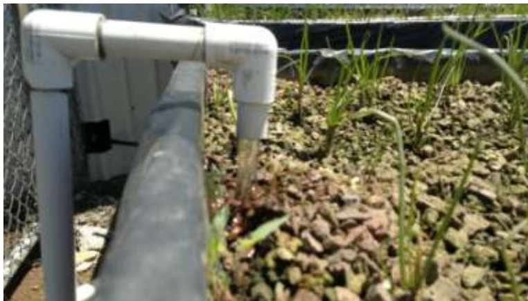
Figura 4.11. Entrada de agua.
